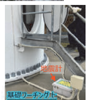
基礎ワーキング 風車の地震観測状況
